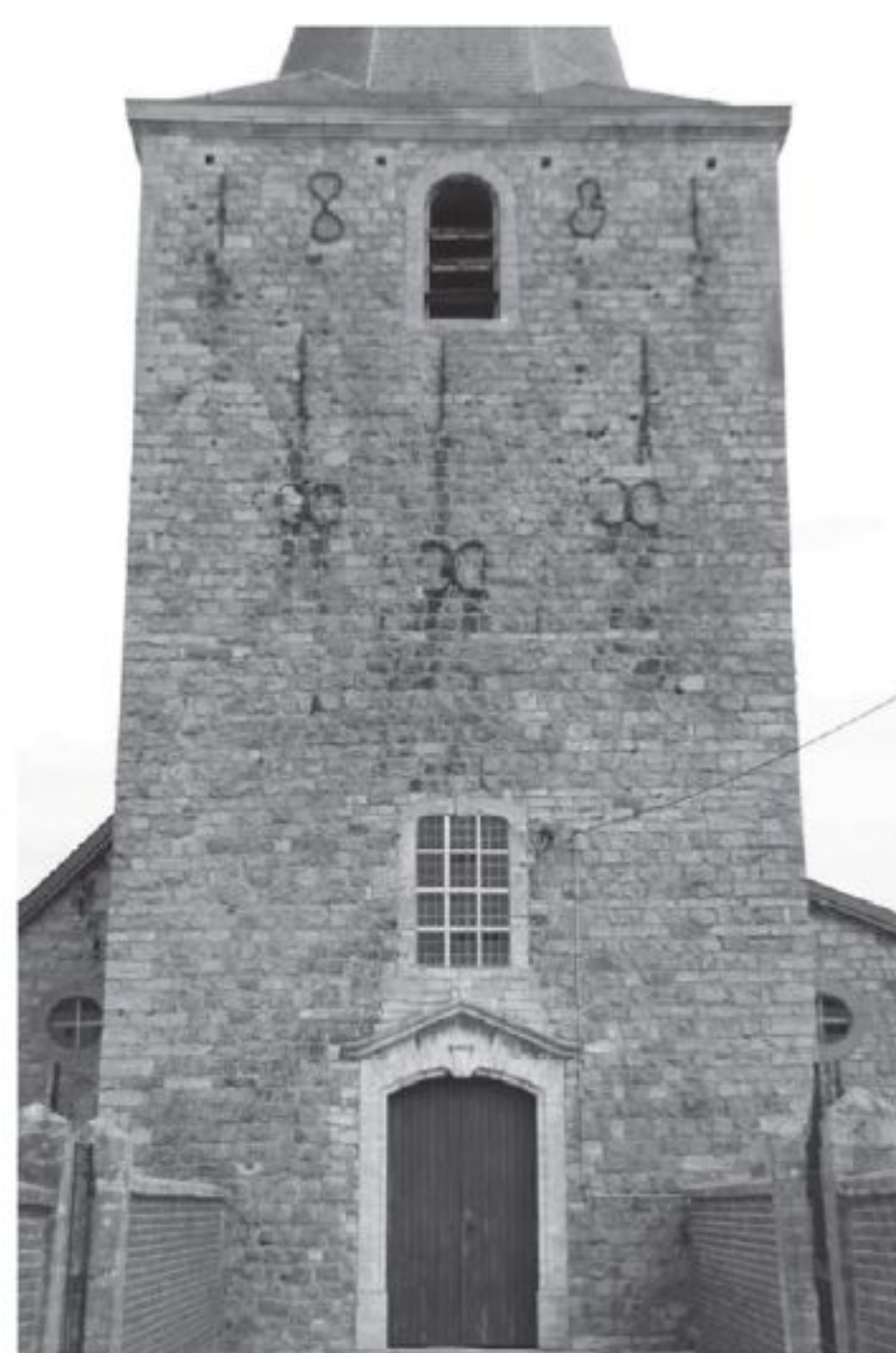
Dégâts causes par ce séisme à l'église de Marilles Schade is nog steeds te zien aan de kerktoeren van Marilles
